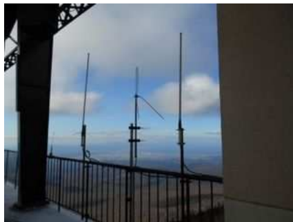
▲山頂駅に設置されたアンテナ
